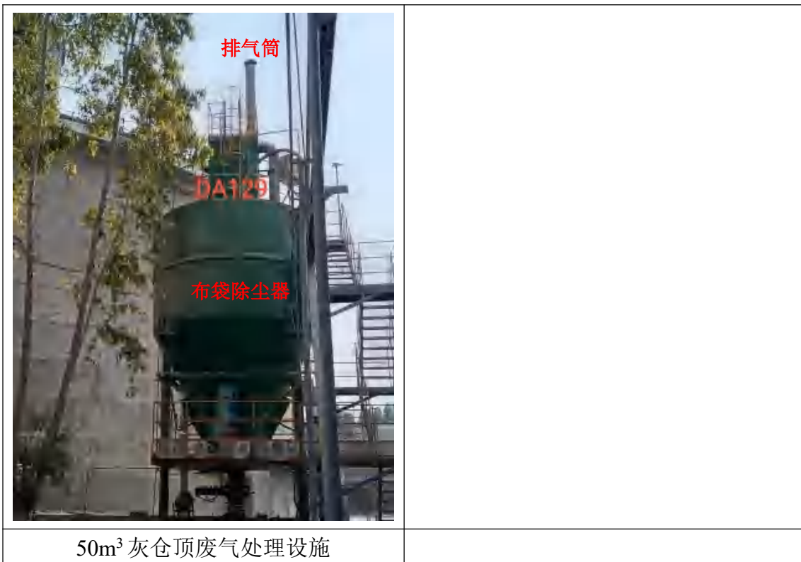
图 4.1-3 废气处理设施实景图
